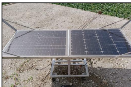
Gambar 1. Panel Surya yang dilapis kaca film
